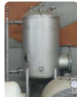
CUVE 615 - Cuve 2400L
